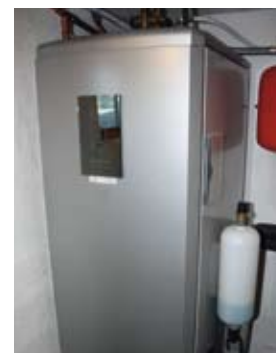
4. Värmepump installerad inomhus
