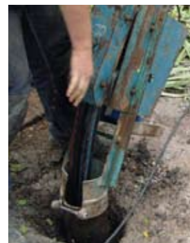
2. Kollektorns anslutning till energibrunn
