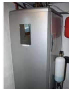
4. Värmepump installerad inomhus
